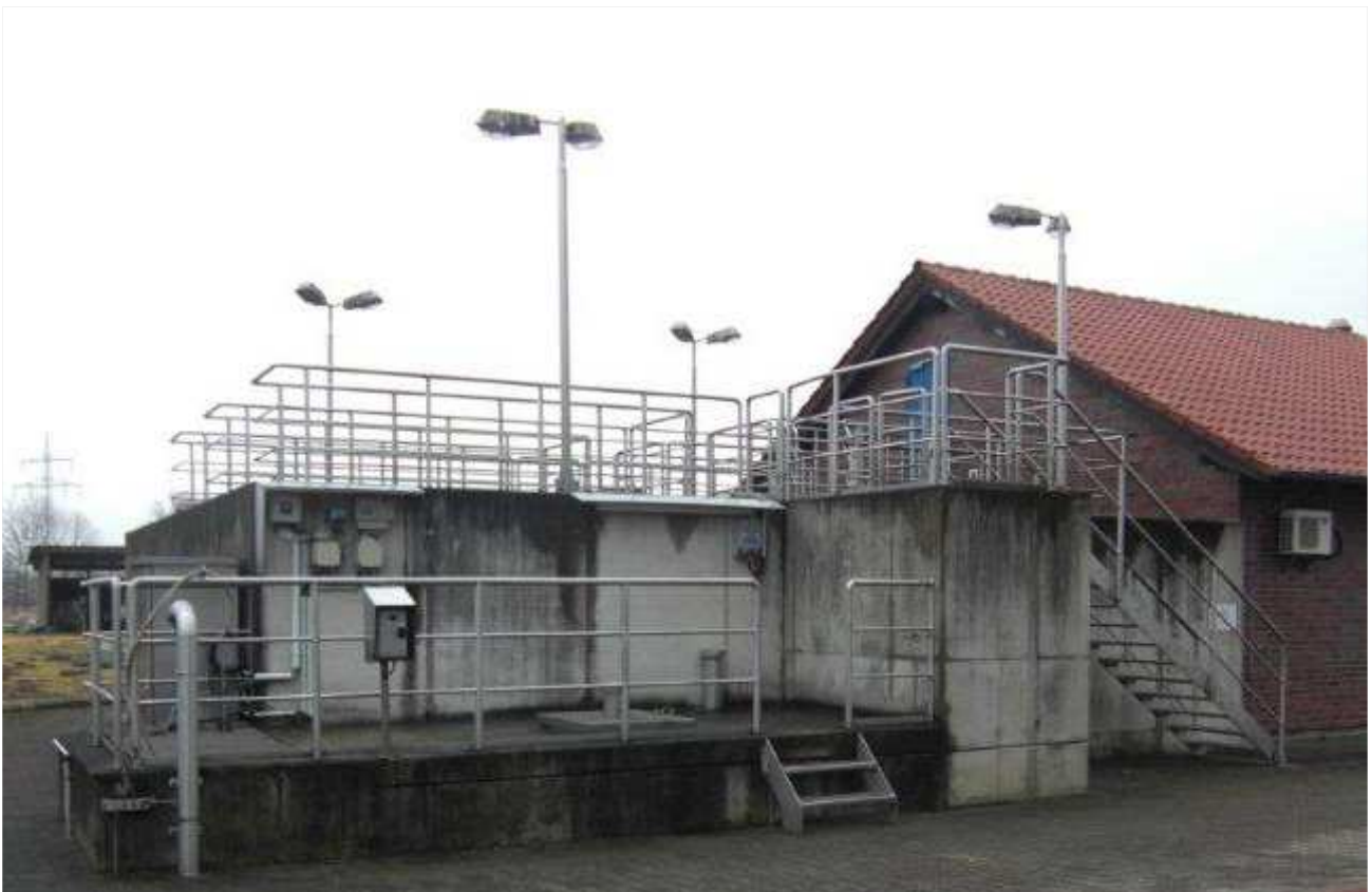
Blick auf die bestehende DynaSand Filtration in Rietberg
